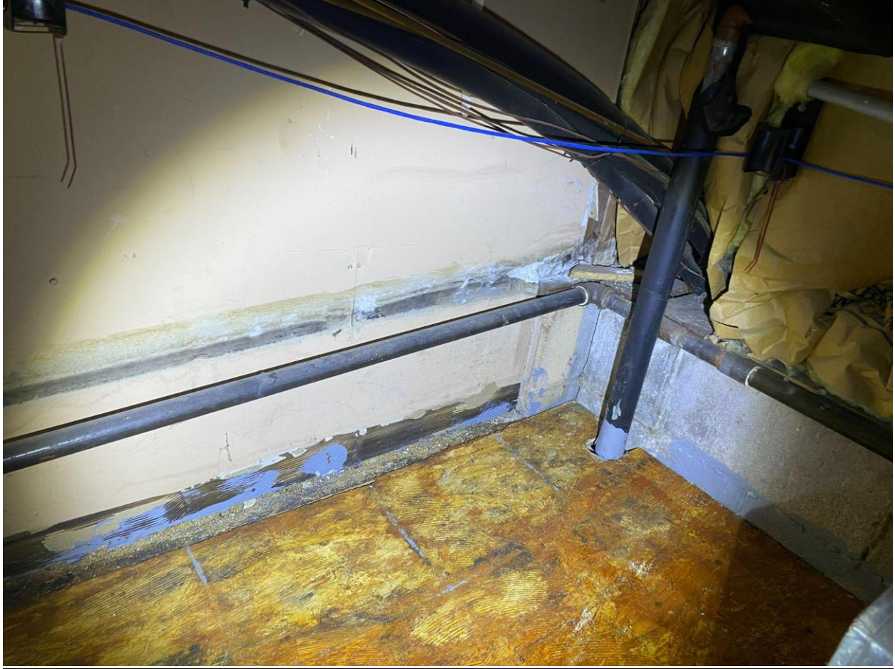
Mold on drywall
