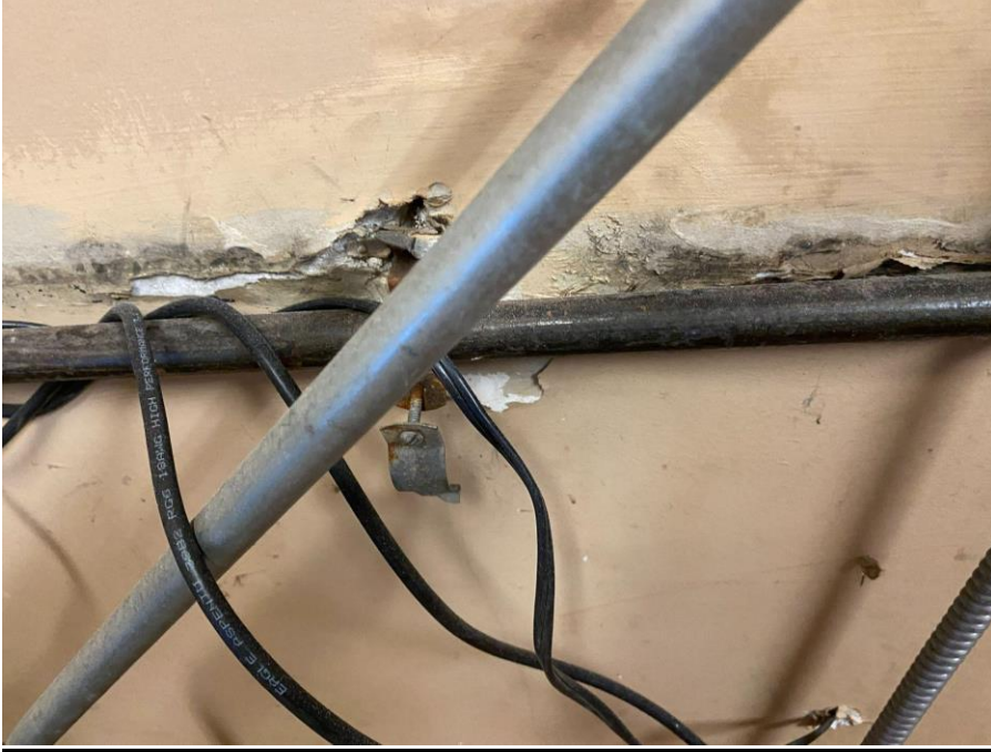
Mold on drywall
