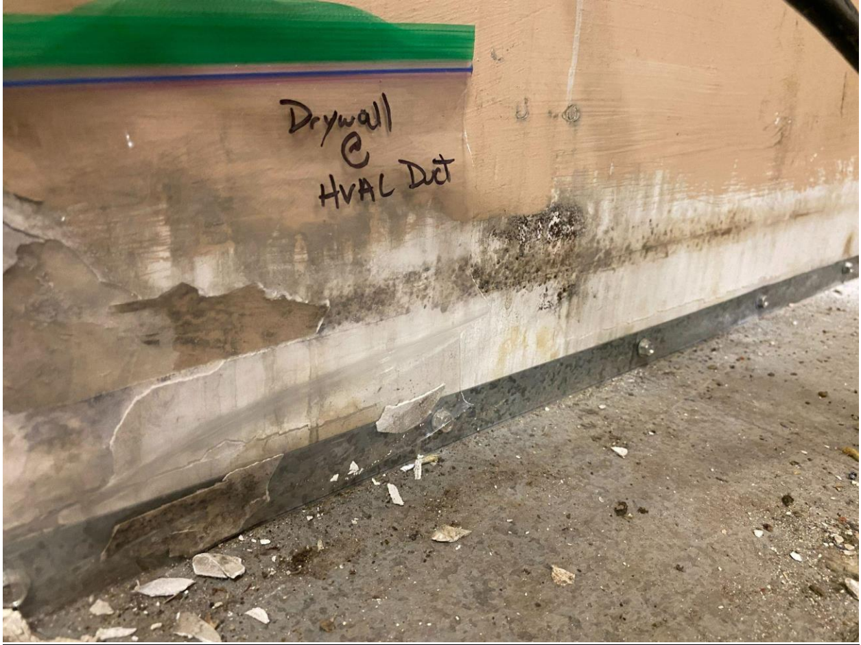
Mold on drywall
