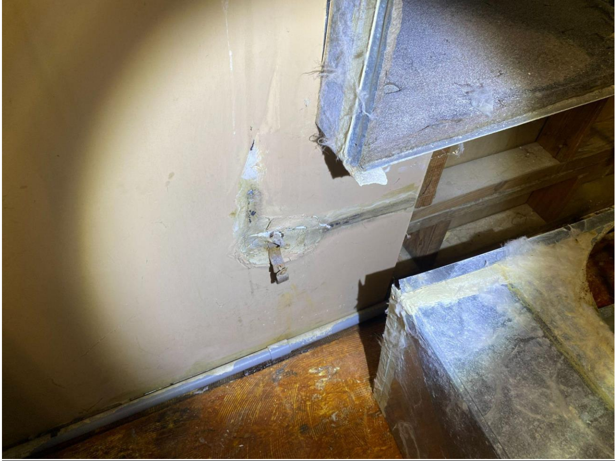
Mold on drywall
